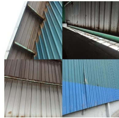
Gambar 1. Kondisi Rangka Atap Baja Gudang
